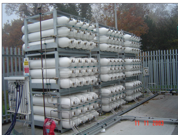
Rys. 3.4. Duży magazyn kaskadowy na sprężony gaz ziemny w stacji sprężania (CompAir)
