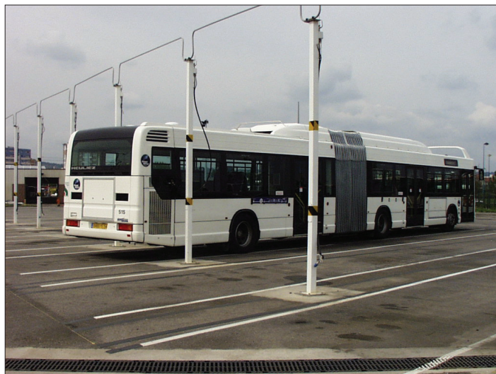
Rys. 3.8. Stanowiska tankowania dla autobusów na stacji powolnego tankowania w jednym z miast francuskich
