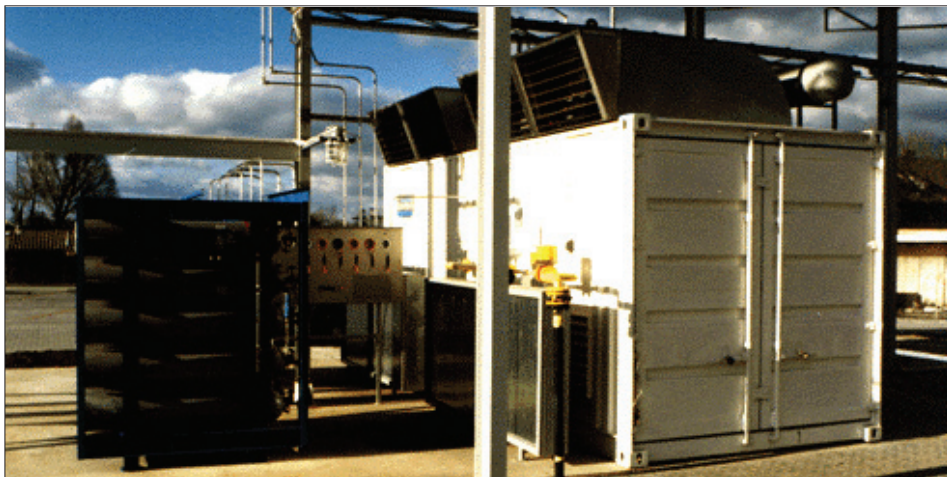
Rys. 3.3. Kontenerowa stacja sprężania gazu AG 2000 firmy NGV Autogas
